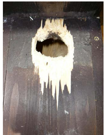
Schäden durch Buntspechte
